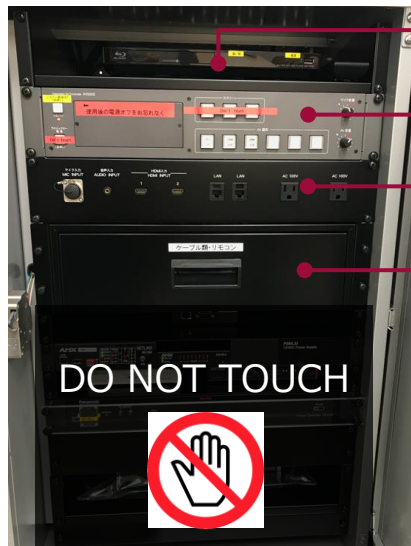
AV操作ワゴン 内部
