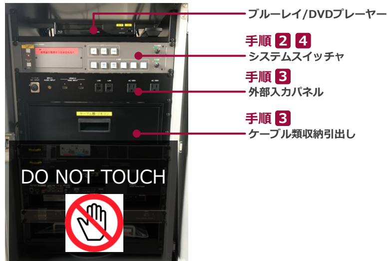
AV操作ワゴン 内部
