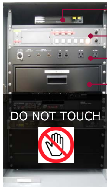
AV操作ワゴン 内部
