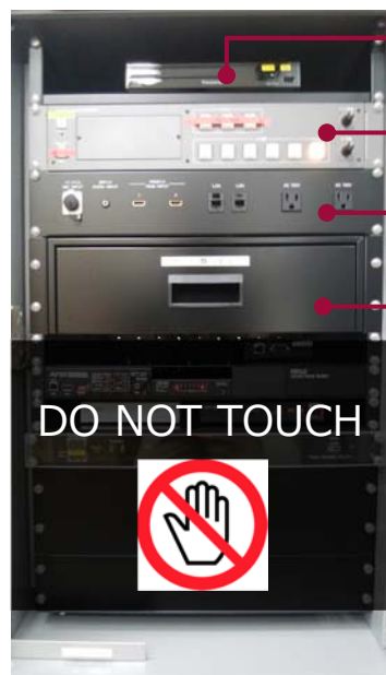
AV操作ワゴン 内部
