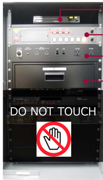
AV操作ワゴン 内部
