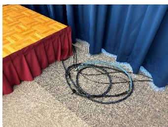
電源ケーブル/LAN ケーブル
